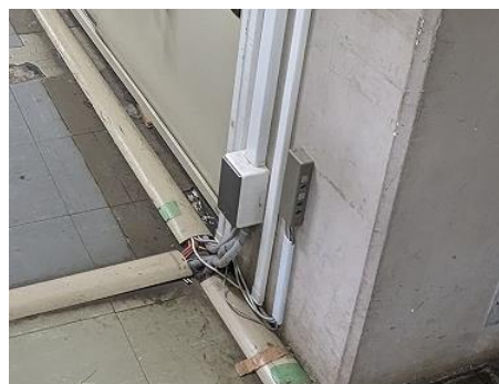
<本庁舎（本館）配線状況>
