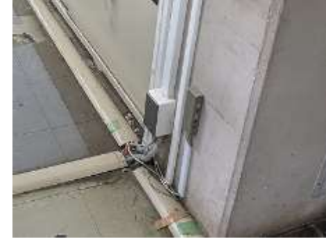
<本庁舎本館 配線状況>
