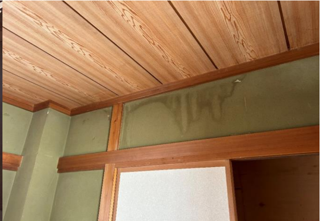
2階6帖和室(北側)壁の雨漏り痕
