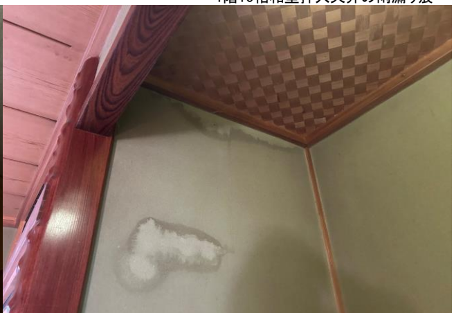
1階10帖和室床の間壁の雨漏り痕
