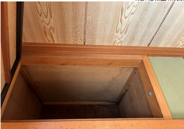
2階6帖和室(南側)押入天井の雨漏り痕
