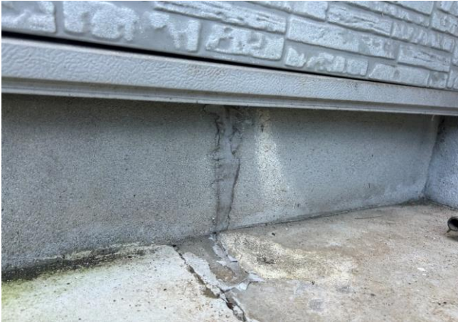
建物北側土台のひび割れ②
