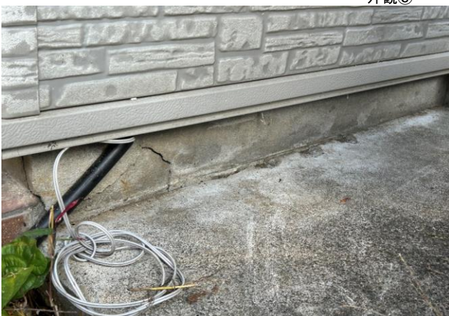
玄関南西側土台のひび割れ
