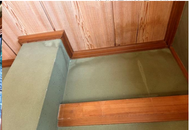
2階6帖和室(南側)天井および壁の雨漏り痕
