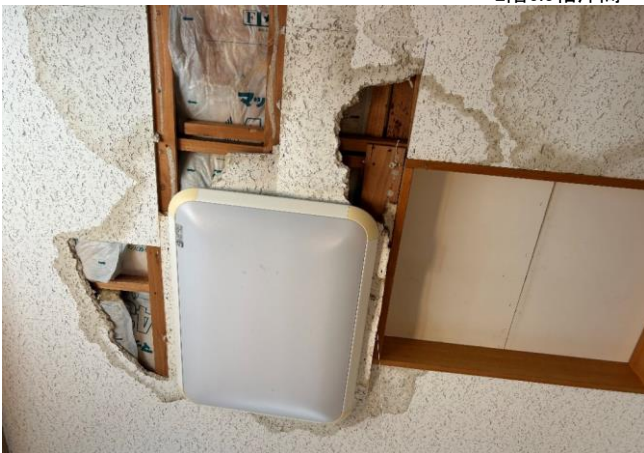
2階7帖洋間天井の雨漏り痕および天井材の欠損
