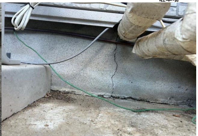
建物北側土台のひび割れ①
