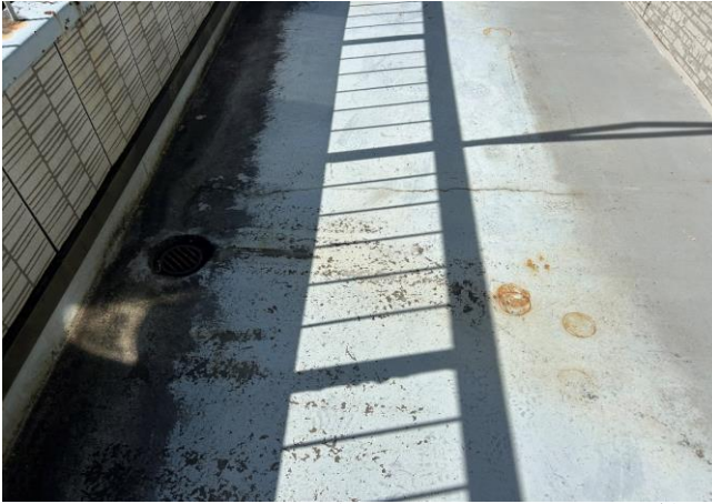
バルコニーの床防止シートのひび割れ
