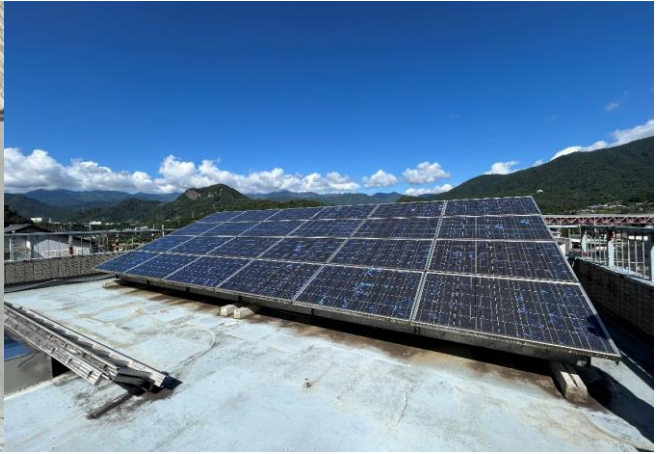
太陽光パネル
