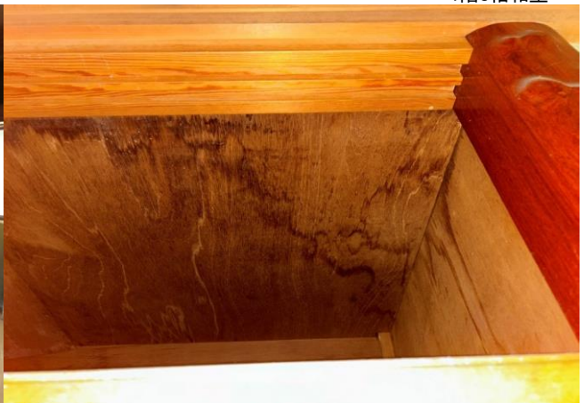
1階10帖和室押入天井の雨漏り痕
