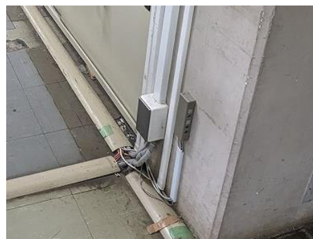
<本庁舎（本館）配線状況>
