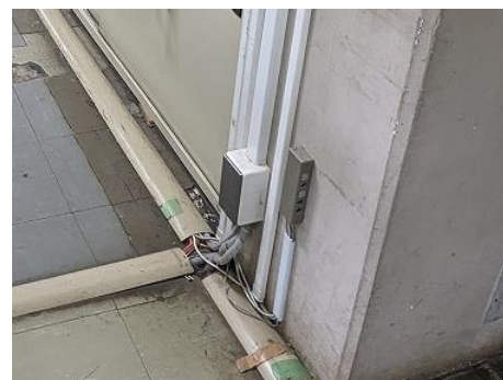
<本庁舎（本館）配線状況>
