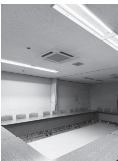
大月市民会館室内エアコン
