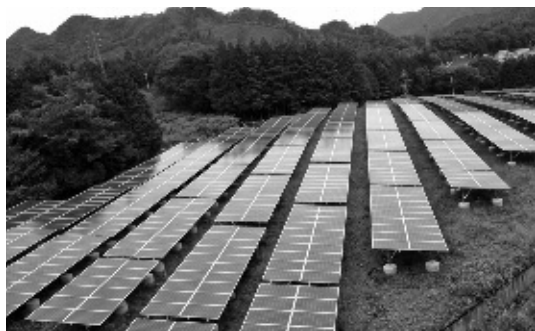
最終処分場に設置された太陽光発電設備
