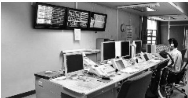
消防署指令室
