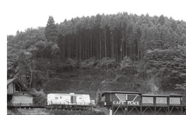
③山の斜面の崩落
