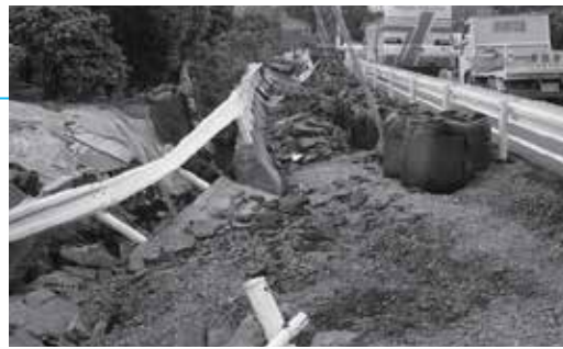
⑥崩落した道路
