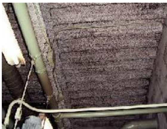
石綿含有吹付けロックウール
