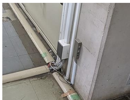
<本庁舎（本館）配線状況>
